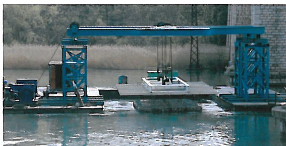
Vernaison (26) : confortement du viaduc SNCF sur l'Isère. Dragages, mise en œuvre de gabions et enrochements
